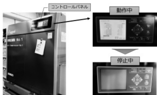
図 圧縮機の電子制御盤コントローラーパネルの動作状態
